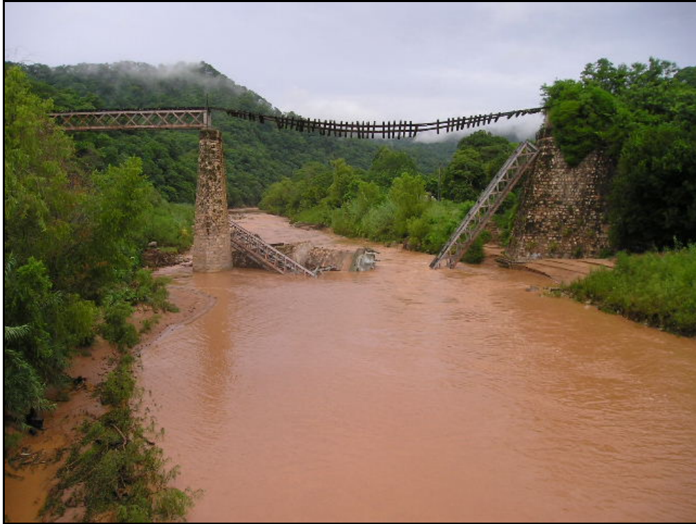
Figura 1.12 Puente ferroviario colapsado por la erosión de márgenes.
