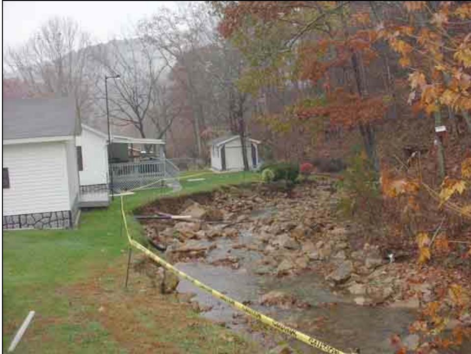
Figura 1.2 Vivienda con riesgo de afectación.
