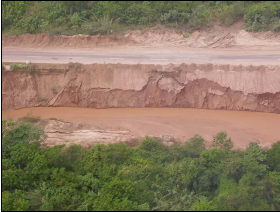
Figura 1.8 Carretera seriamente afectada por la erosión de márgenes.
