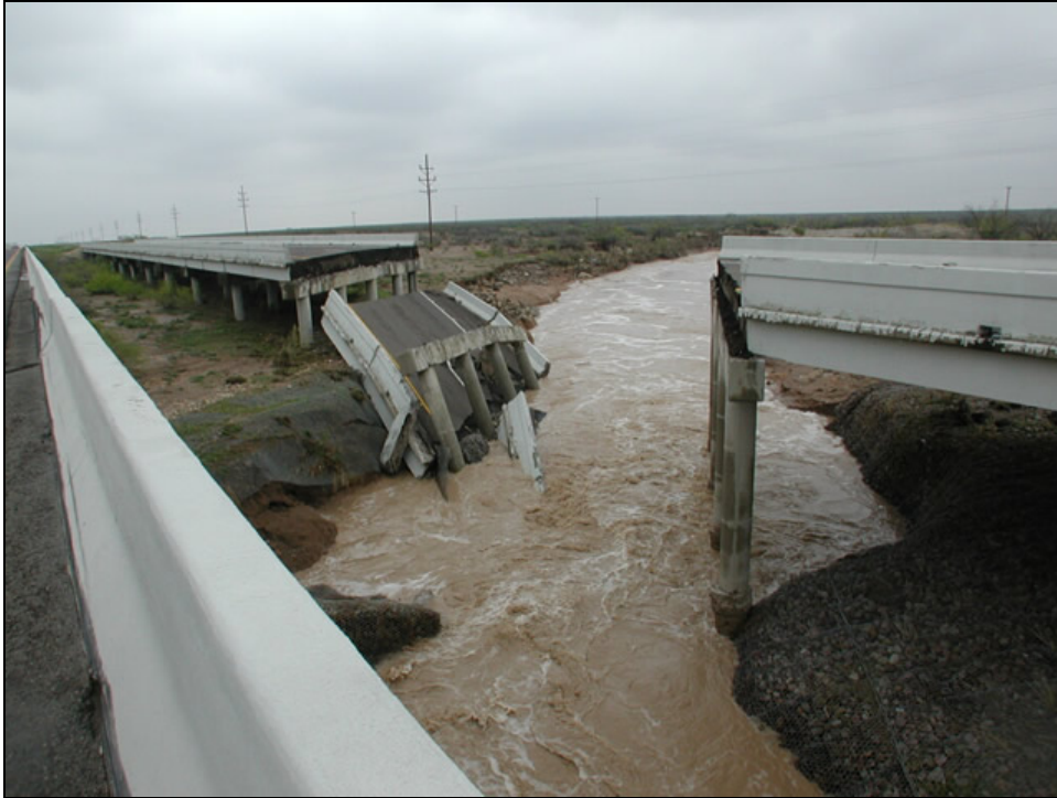
Figura 1.10 Puente vial afectado por la erosión de márgenes.
