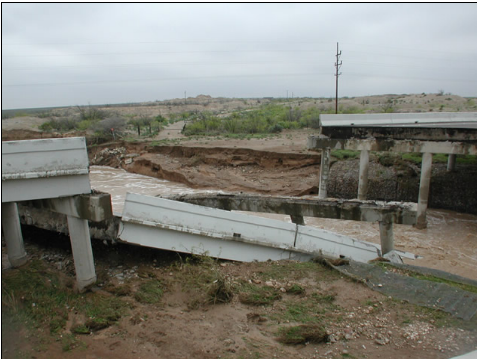
Figura 1.11 Puente vial afectado por la erosión de márgenes.
