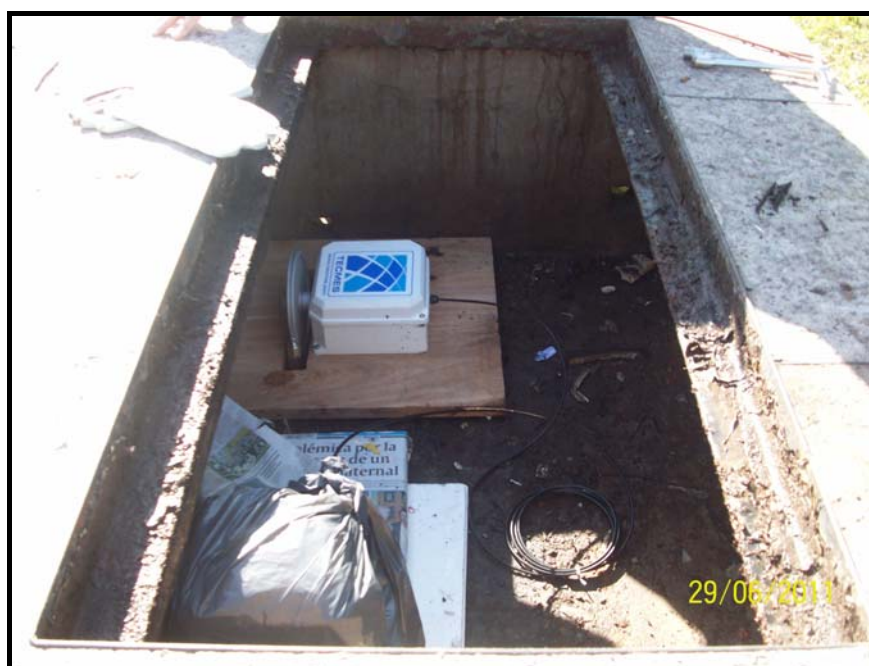
Foto Nº 3: Limnigrafo instalado en casilla protectora
