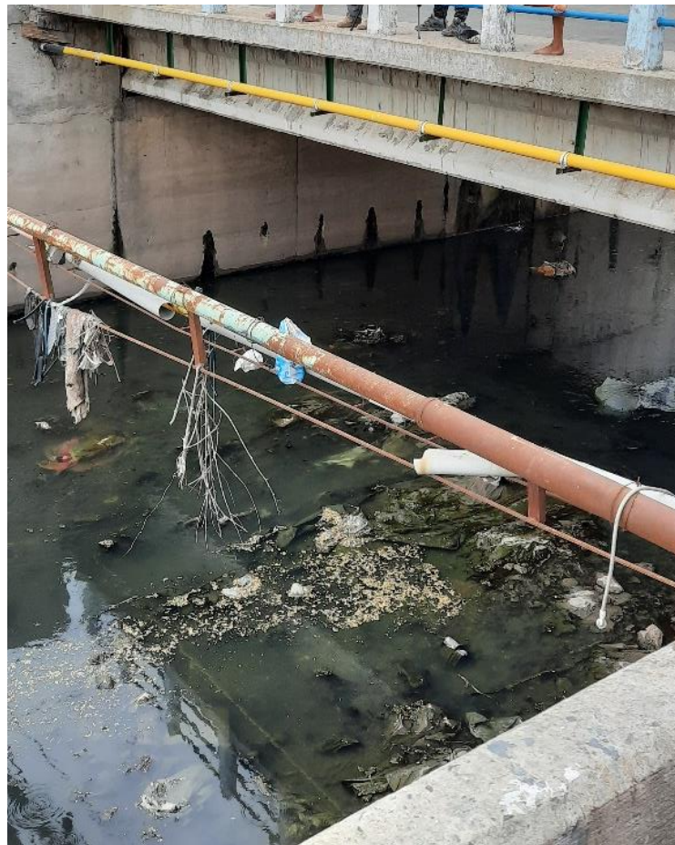
Figura 2.7. Residuos flotantes en la EM16.
