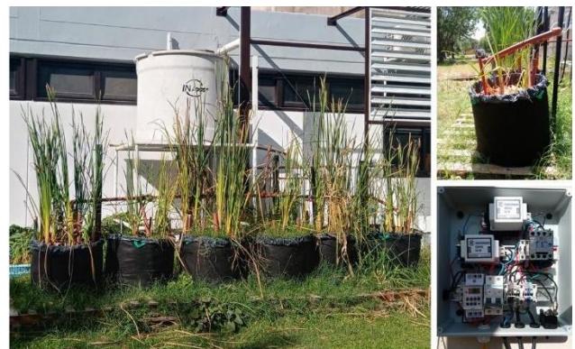
Figura 1.- Sistema de alimentación de 6 Humedales Construidos, sistema de riego y tablero de control.
