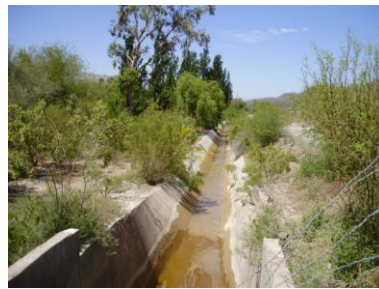
Figura N°3. Regular estado. Canal Falda (Zonda)
