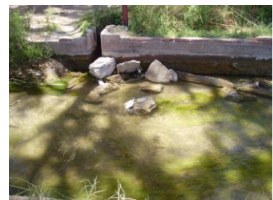
Figura N°7. Estado de mantenimiento nulo
