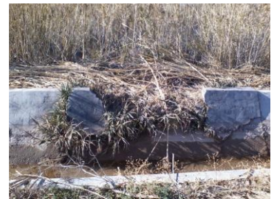
Figura N°4. Mal estado. Canal Falda (Ullúm)
