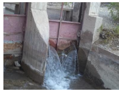
Figura N°10. Compuerta en mal estado. N°2 Canal General en Ullúm
