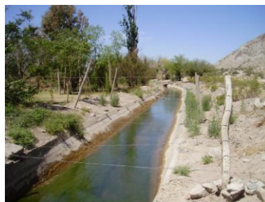
Figura N°6. Estado de mantenimiento escaso.
