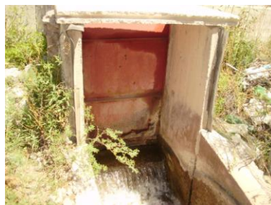
Figura N°9. Compuerta en regular estado. N°1916 Canal Barros en Zonda
