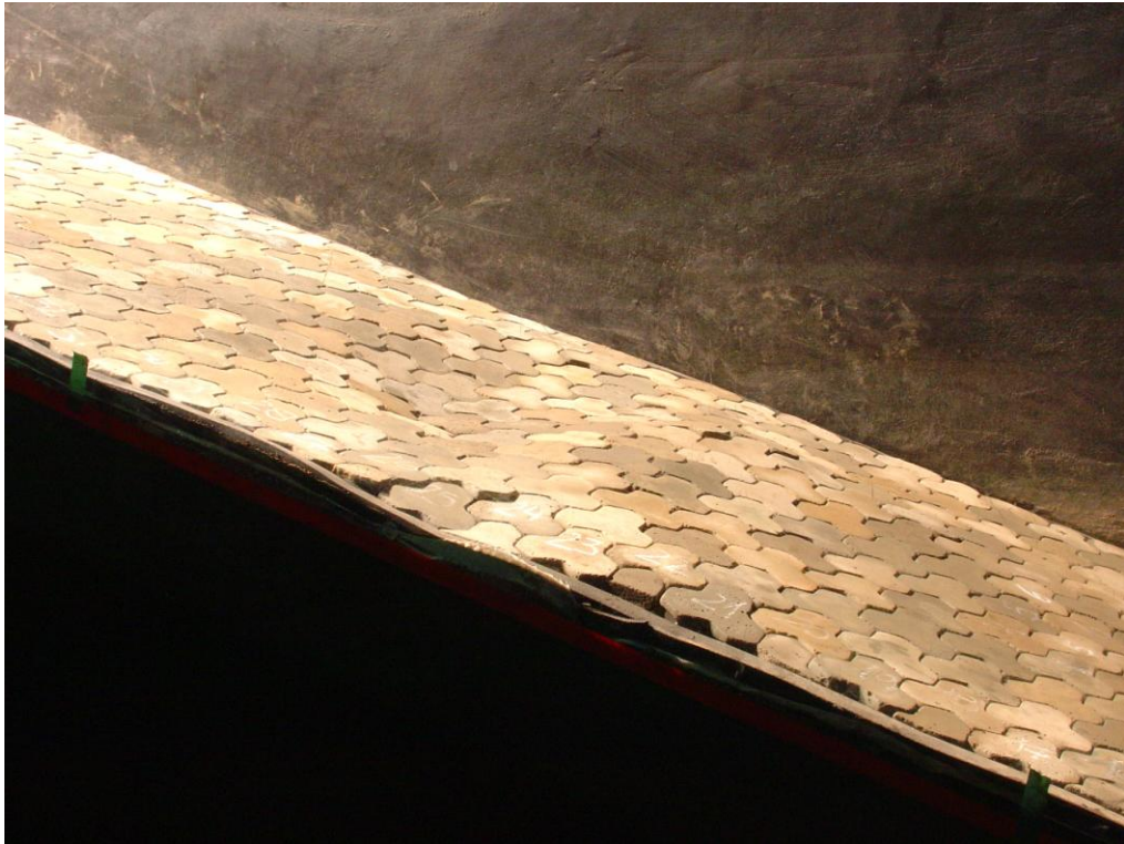
Foto 8: Estado final del revestimiento en uno de los casos que ocurrió la deformación excesiva del talud.
