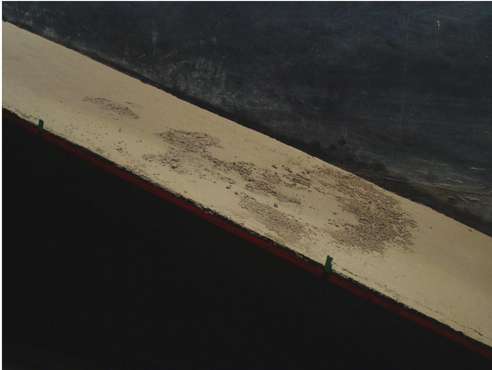
Foto 7: Estado final del talud luego de una falla típica.
