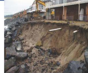
Erosión costera en Mar del Tuyú:
