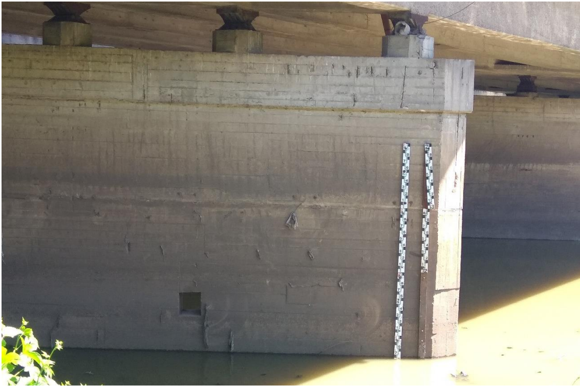
Figura A.31. Regla hidrométrica de la EM12 ubicada en la pila cercana a margen derecha.
