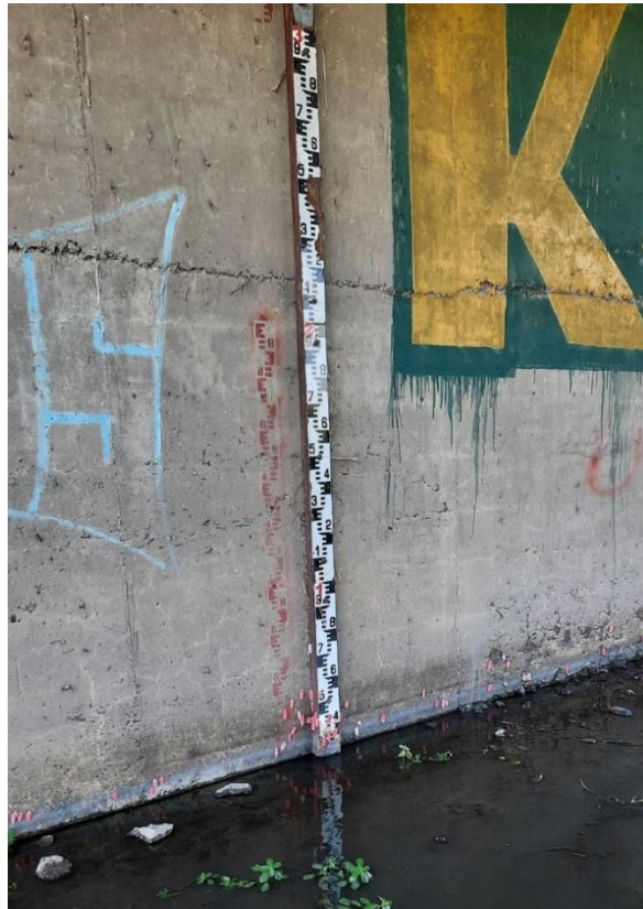
Figura A.45. Regla hidrométrica de la EM33. Se observan los primeros tres tramos en planchas enlozadas mientras que el tramo 4 se encuentra pintado en el estribo del puente.
