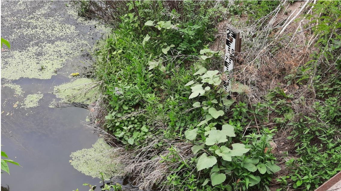
Figura A.64. Tramo 2 de la regla hidrométrica, sobre margen derecha, cubierta con vegetación.
