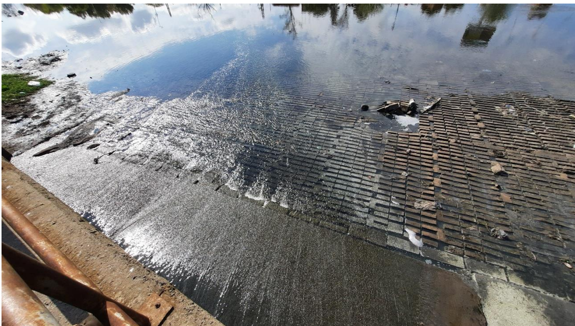
Figura A.81. Vista superior de la descarga del Aliviador del arroyo Cildañez.
