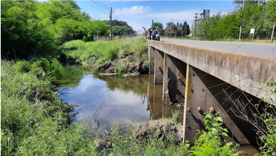
Figura A.23. Escala hidrométrica de la EM10. Se observa vegetación atrapada en la misma que dificultaba la lectura de niveles en el arroyo Aguirre.
