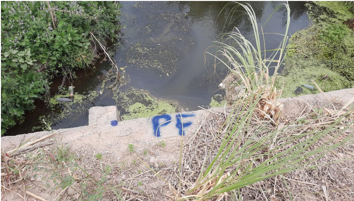
Figura A.60. Nuevo Punto Fijo marcado sobre estructura de alcantarillas inmediatamente aguas debajo de la sección de aforo.
