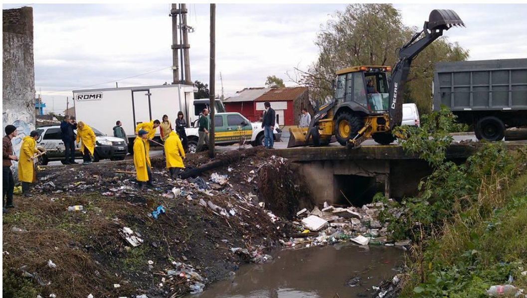
Figura AI.13. Arroyo Las Piedras cruce con la Av. San Martín (Quilmes Oeste –Quilmes).
