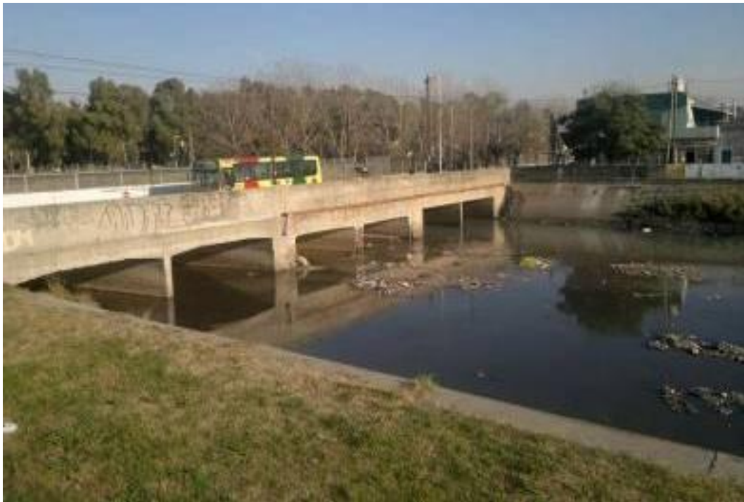
Figura AI.5. Canal Santo Domingo visto desde aguas abajo. De izquierda a derecha las salidas de: Arroyo Las Piedras, San Francisco y Las Perdices 19 .
