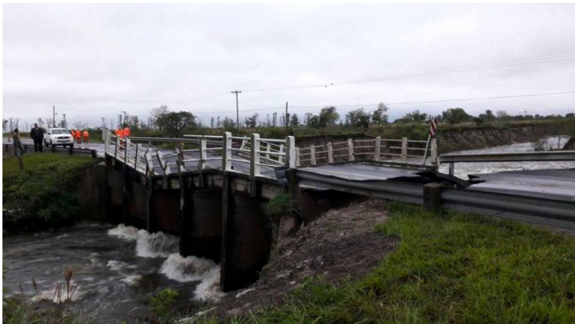
Figura 3.9. Falla del puente sobre el A° Iribú Cuá. Vista desde aguas arriba.
