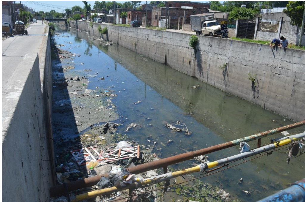
Figura 2.7. Residuos flotantes en la EM16.
