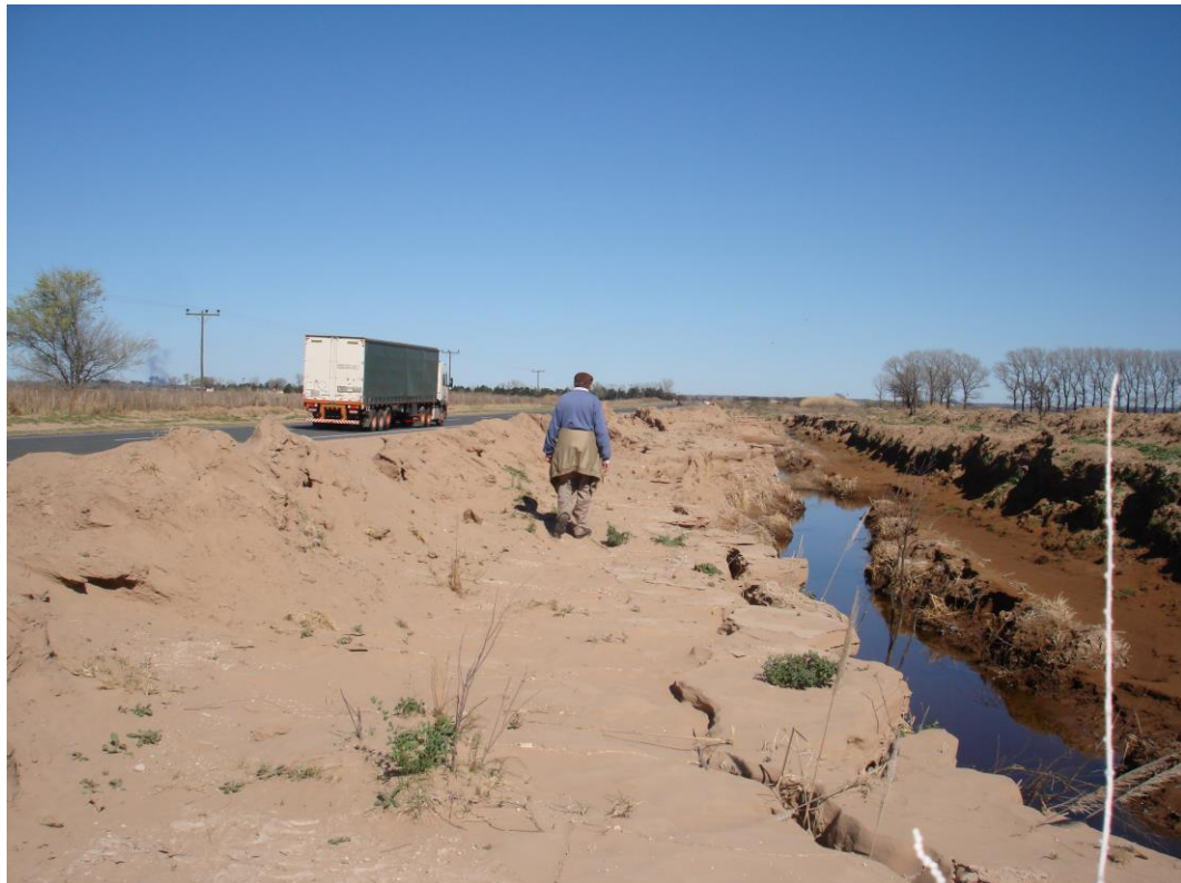
Fig. 56. Canal de trasvaso. Evidencias de potenciales desplomes por socavación de márgenes.
