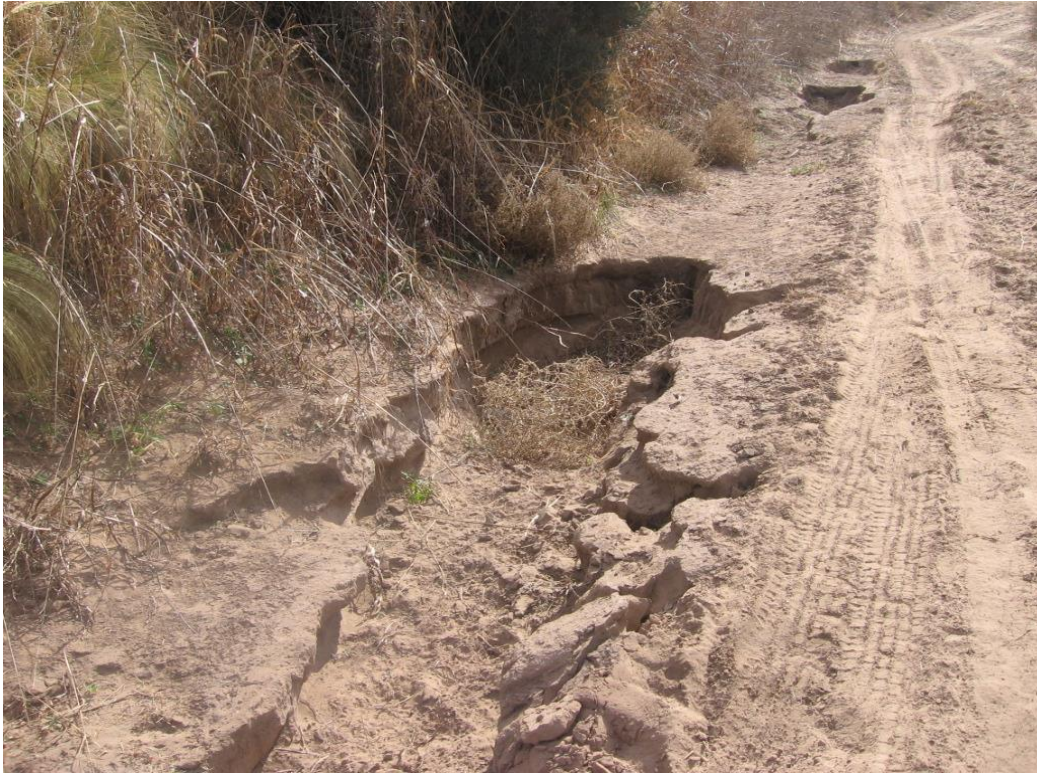
Fig. 27. Proceso de erosión tubificada – piping y colapso en procesos de encadenado por erosión, Camino secundario. Sistema A° La Punilla.
