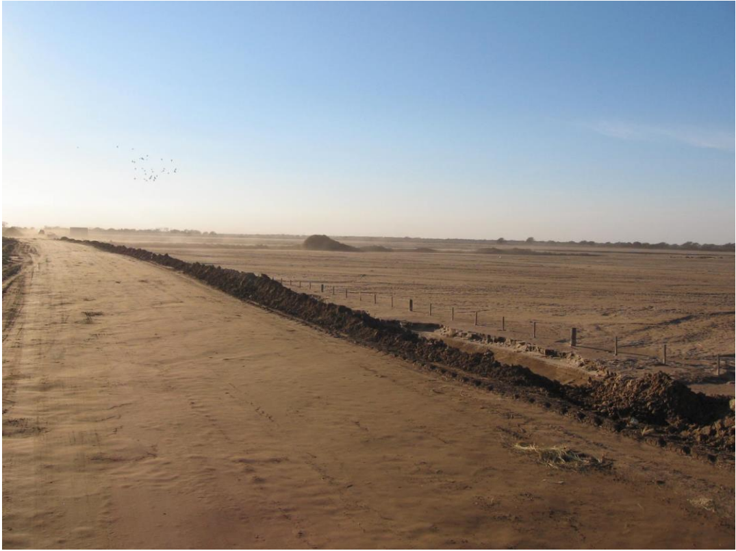
Fig. 70. Depresión La Salada . Fuerte acumulación aluvional por el efecto retención de la Ruta Nac. N° 8 por desagües insuficientes.
