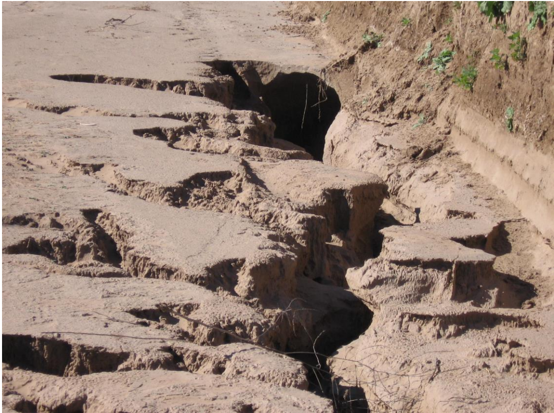
Fig. 49. Procesos de erosión tubificada-piping y posterior colapso en camino secundario.
