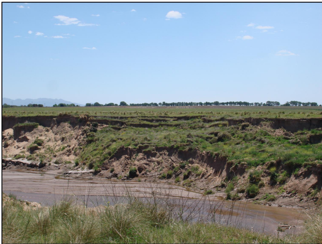
Fig. 62 Desplome lateral de magnitud por socavación de margen.
