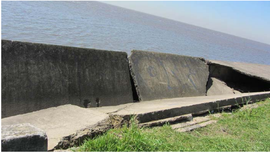
Figura 2.28. Defensa deteriorada - Zona Pejerrey Club.
