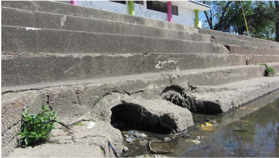
Figura 2.19. Descargas pluviales - Zona Pégola.
