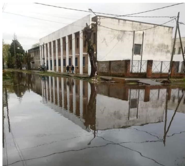
Figura 2.22: Anegamiento en acceso a escuela. Fuente: Facebook “Vecinos Varelesenses”.
