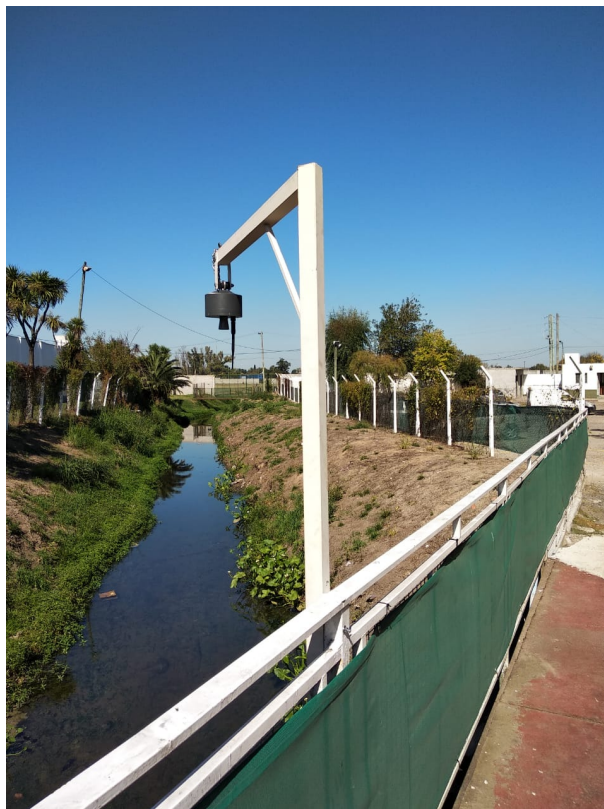
Figura 3.15: Sensor de nivel ubicado en el predio de Defensa y Justicia. Foto: Meteovarela.
