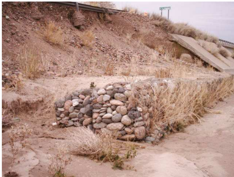
Figura 14.- Socavaci6n fondo losa estribo izquierdo y depositaci6n sobre gaviones existentes
