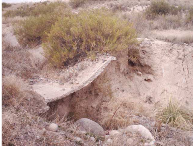
Figura 15.- Rápida de bajada de zanja de guardia. (losas con erosión retrógrada)
