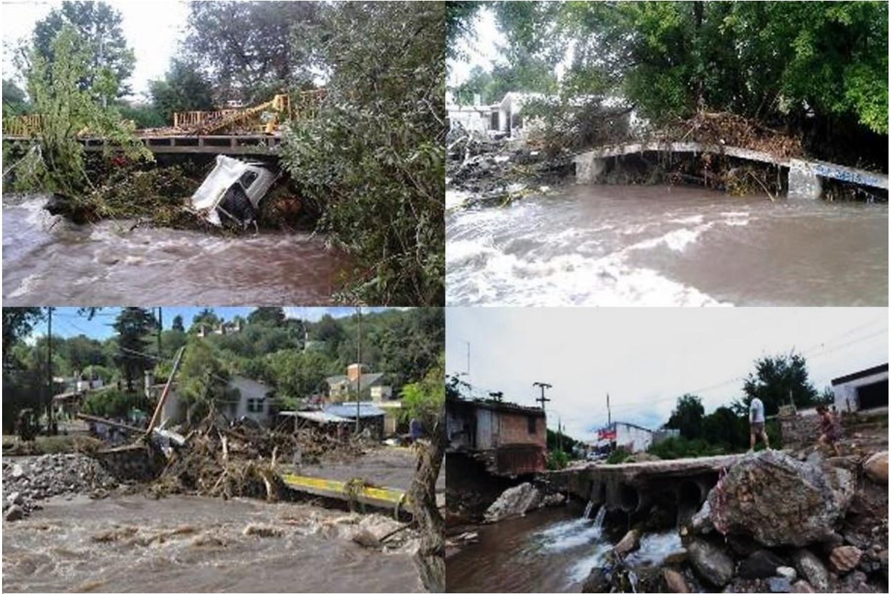
Figura 29. Imágenes de puentes obstruidos y colapsados durante la creciete de Febrero de 2015.
