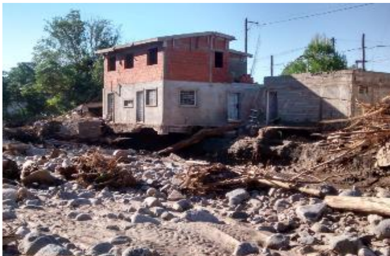
Arriba; imagen correspondiente al año 2014 sobre ruta intermunicipal E-57. Medio; fotografía tomada posterior al 15 de febrero de 2015. Abajo; vivienda afectada por la creciente.
