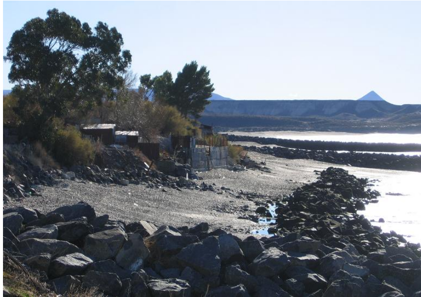
Foto 5.7 – Defensas costeras precarias en el frente urbanizado
