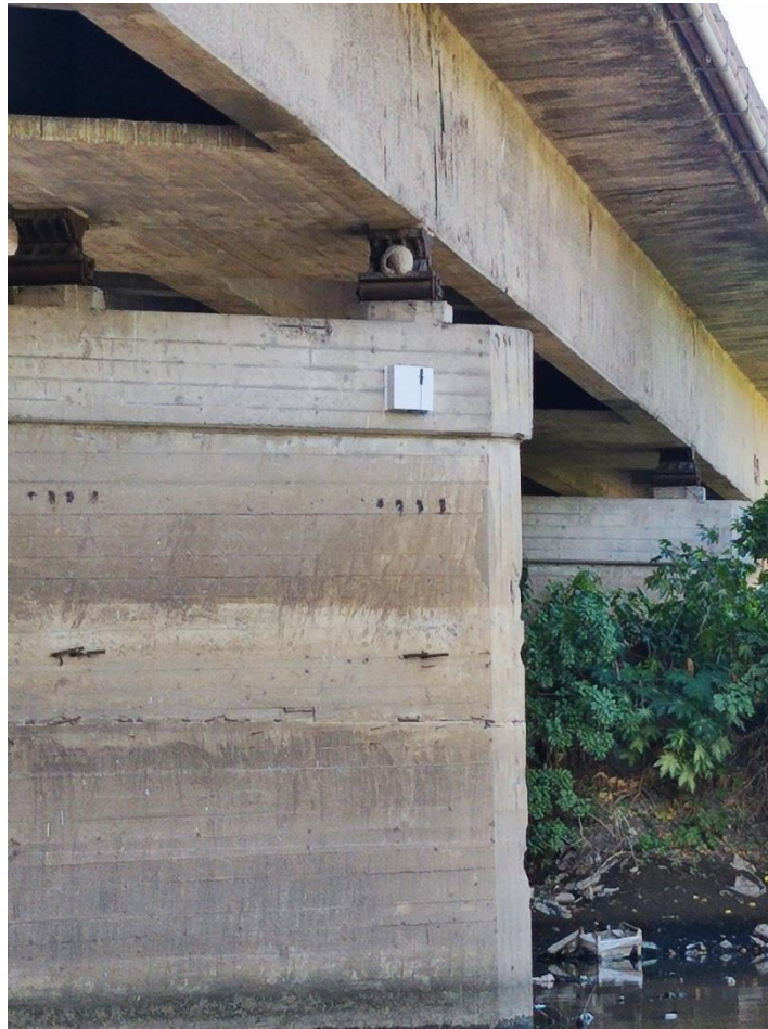
Figura 2.4. Ubicación del sensor instalado en la EM12.
