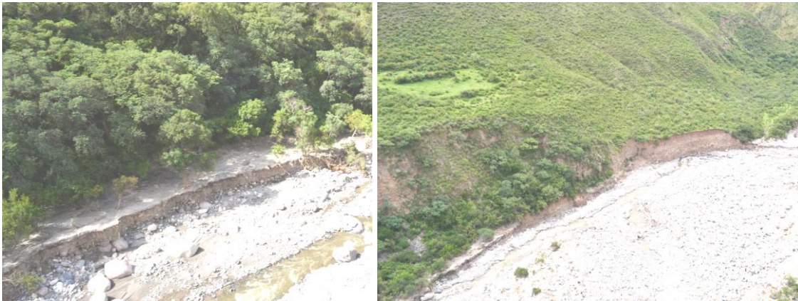
Figura4.- Erosión de márgenes sobre nivel inferior de terraza. Río Ambato. Sobrevuelo del 01/02/2014.
