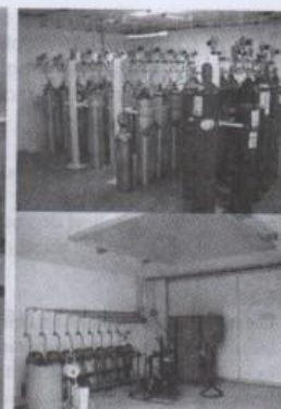
Figura 11 y 12. Salas de gases y combustibles
