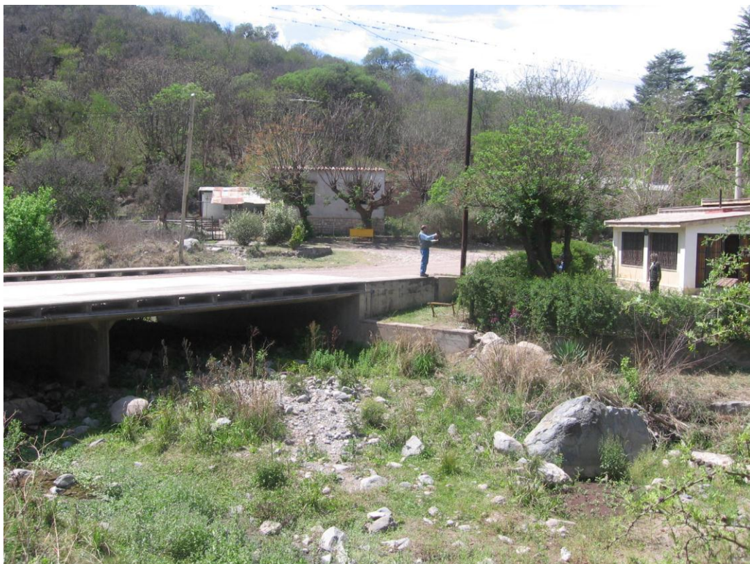
FOTO 15. Vivienda sobre borde del lecho ordinario. Puente sobre Av. Belgrano. Máximo riesgo en crecientes ordinarias máximas y extremas a lo que se le suma el efecto retardo y desvió del puente. A° Cabana.
