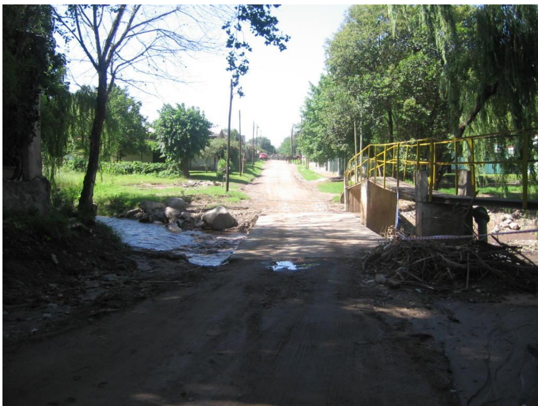
FOTO 8. Idem foto 7. Resaca en pasarela que por efecto embalse complica la situación de amenaza.
