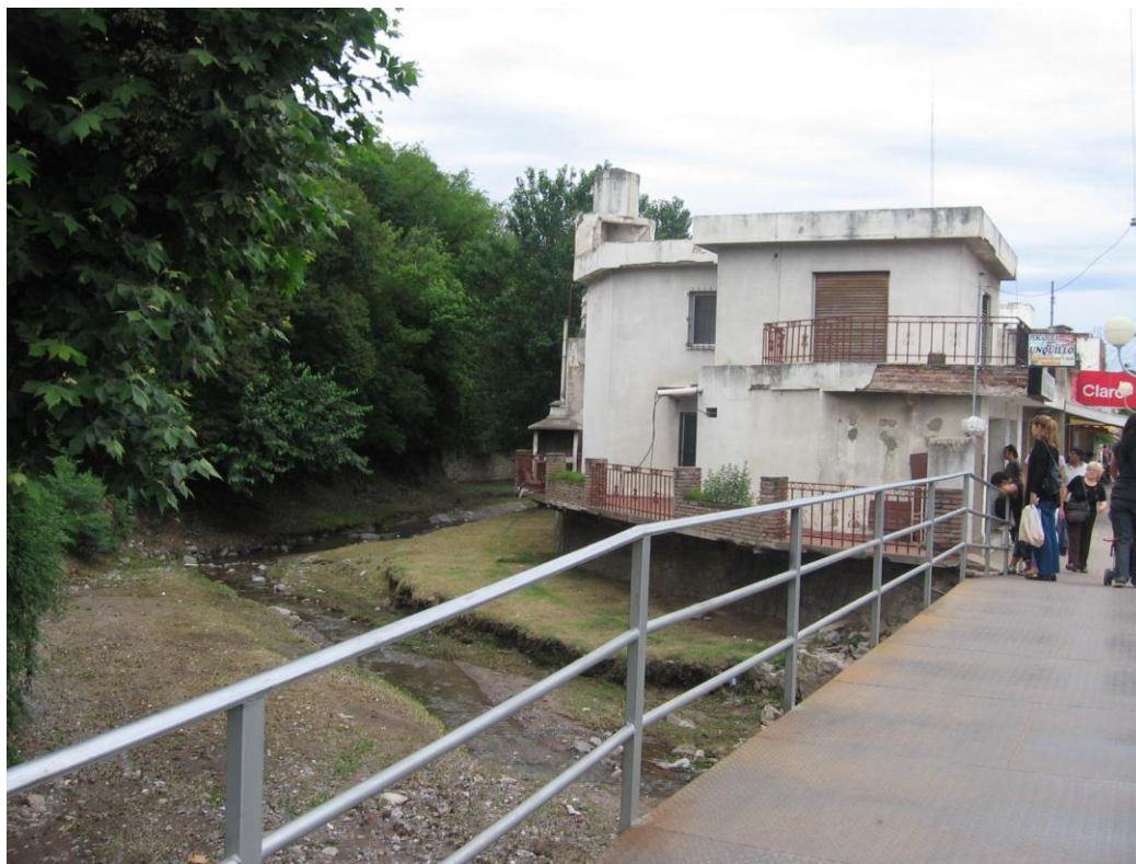
FOTO 5. Puente Av. San Martín. Lecho ordinario y viviendas a la margen derecha sobre terraza inferior inundable ante la ocurrencia de crecientes ordinarias máximas. La avenida actúa como brazo de crecida por desborde. Alto riesgo en crecientes extremas.
