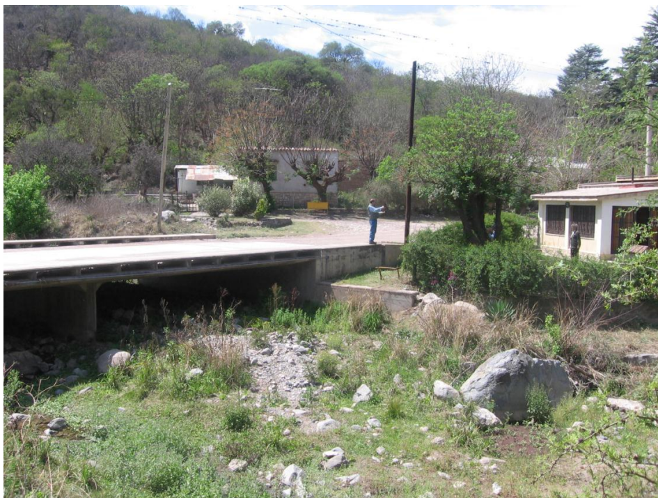
Fig. 13. . A° Cabana. Nivel de terraza inferior (T2) inundable ante la ocurrencia de crecientes ordinarias. Amenaza severa en crecidas ordinarias.
