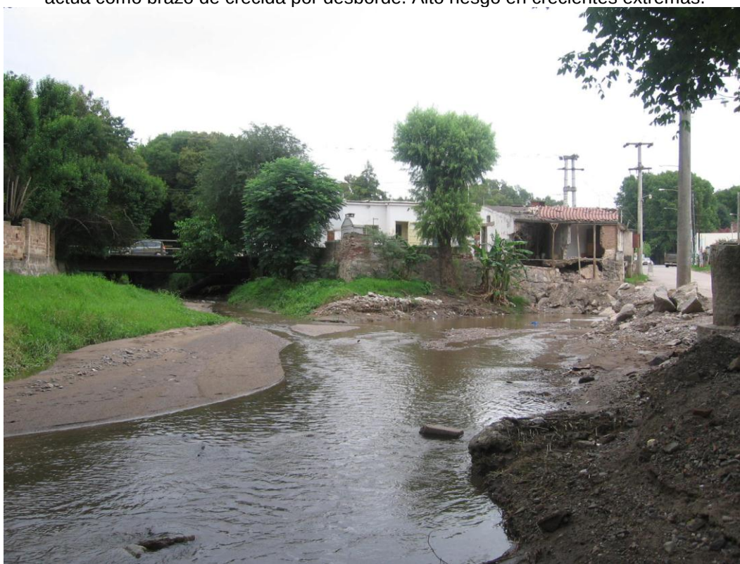
FOTO 6. Vivienda destruida sobre terraza inferior inundable ante la ocurrencia de crecientes ordinarias máximas. Confluencia de los arroyos Unquillo y Río Ceballos, Alto riesgo en crecientes extremas.
